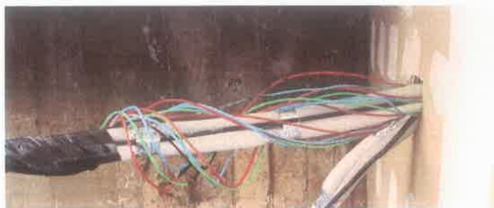
Figura 28 - Fiação sem tubular.
