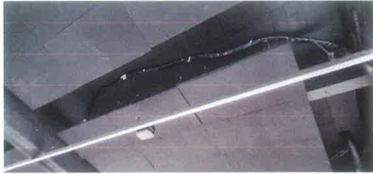
Figura 25 - Tubulação de gas instalada sem uso de ferramenta apropriada. resultado: sem alinhamento.
