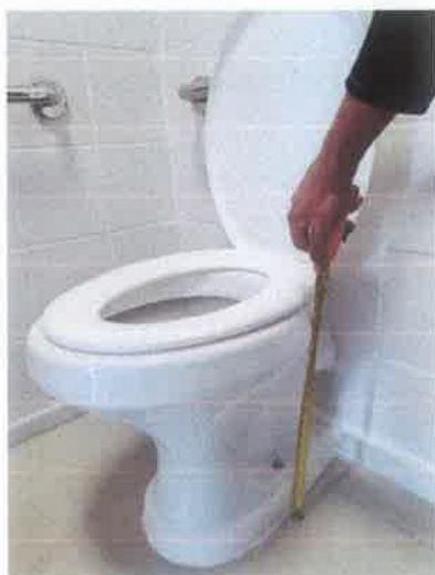
Figura 32 – Inconformidade de dimensão de vaso sanitário.
