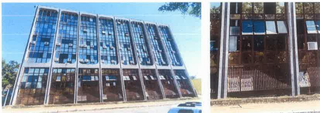
Figura 21 – Ausência da instalação dos suportes metálicos das condensadoras na fachada externa posterior da edificação.
