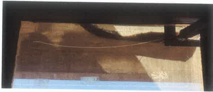
Figura 22 - Falta de técnica para a passagem das tubulações até os condensadores - dano no vidro.
