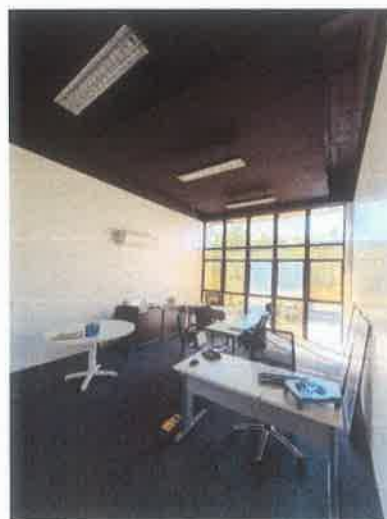
Figura 62 – Divergência teto ambiente PRESIDÊNCIA.
