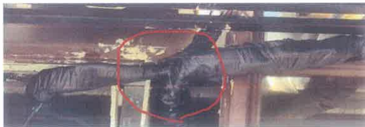
Figura 27 - Tubulação com estrangulamento na passagem de gás.
