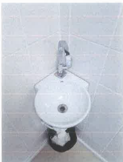
Figura 30 – Inconformidade de dimensão do lavatório.
