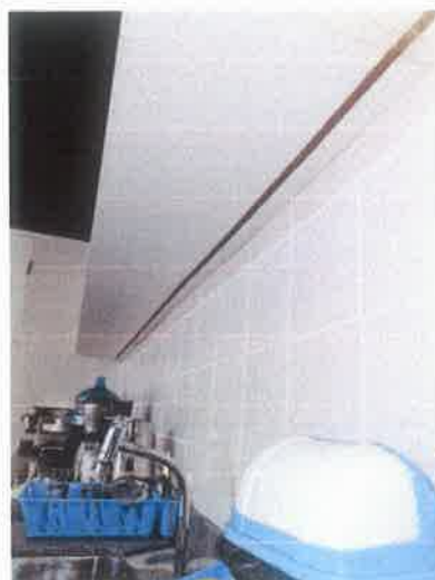
Figura 44 – Ausência de perfil led embutido no armário.
