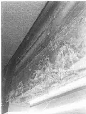
Figura 69 – Ausência de lixamento da superfície de concreto.
