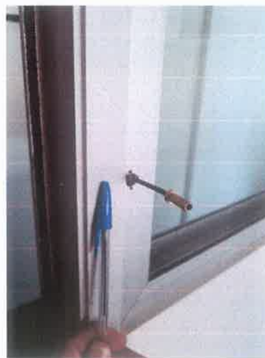
Figura 53 – Ausência de acabamentos.
