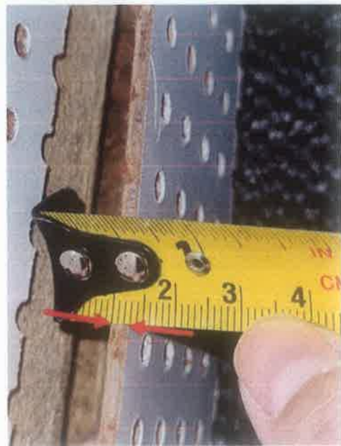
Figura 50 – Inconformidades quanto a espessura da chapa utilizada no painel acústico: instalado peça de 3mm.
