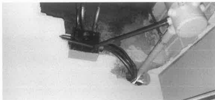
Figura 7 - Cabos instalados fora de eletrodutos
