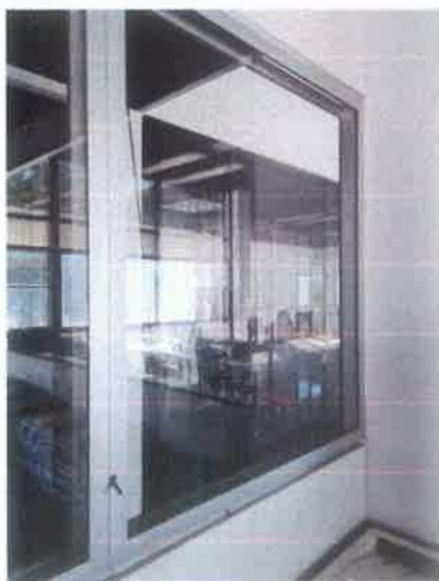
Figura 52 – Ausência de persianas.
