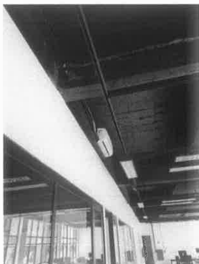
Figura 18 – Inconformidades de execução do local de instalação das evaporadoras.
