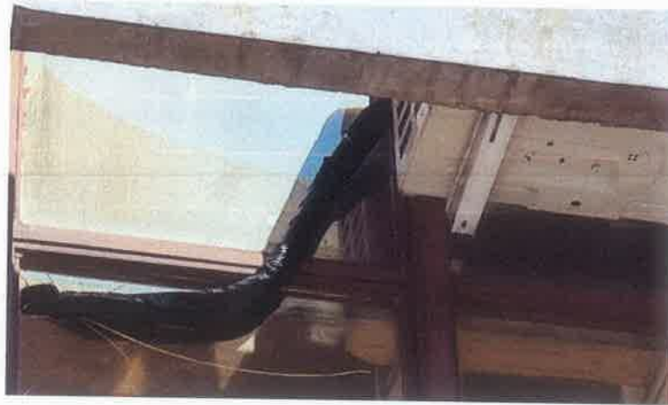
Figura 23- Falta de técnica para a passagem das tubulações até os condensadores - dano no vidro.
