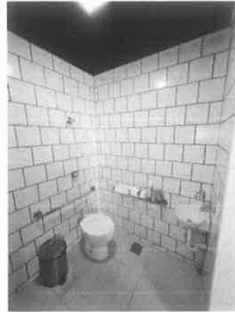
Figura 68 – Divergência teto ambiente SANIT. PNE.
