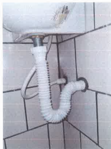
Figura 31 – Inconformidade do tipo de sifão e ausência de acabamento tipo canopla.
