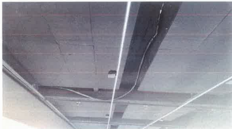
Figura 26 - Tubulação de gas instalada sem uso de ferramenta apropriada. resultado: sem alinhamento.
