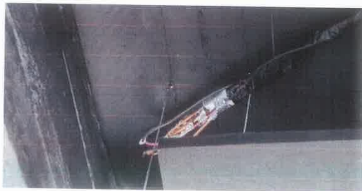
Figura 24 - Tubulação de gas e fiação passado juntas. O calor na tubulação de alta, condensado, danificará o isolamento da fiação com o tempo.
