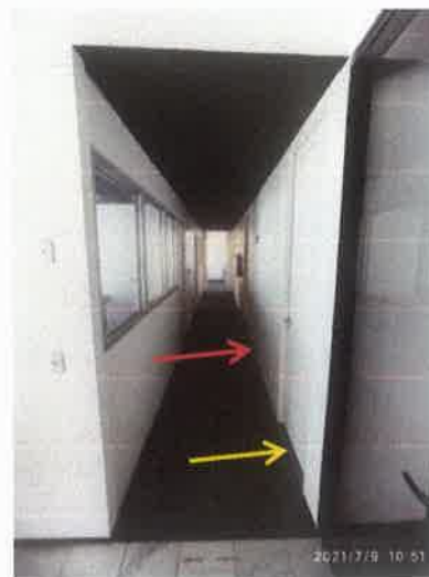
Figura 59 – Divergência quanto ao local previsto para instalação de porta do ambiente ARQUIVO.
