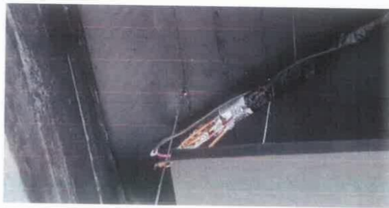
Figura 24 - Tubulação de gas e fiação passado juntas. O calor na tubulação de alta, condensado, danificará o isolamento da fiação com o tempo.
