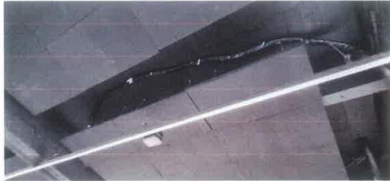
Figura 25 - Tubulação de gas instalada sem uso de ferramenta apropriada. resultado: sem alinhamento.
