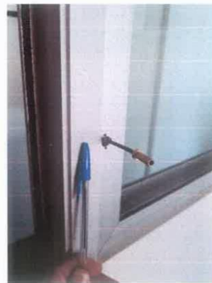
Figura 53 – Ausência de acabamentos.
