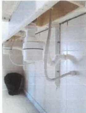
Figura 34 – Inconformidade do tipo de sifão a ser instalado.
