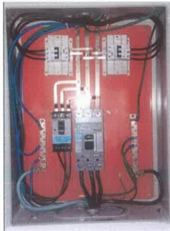
Figura 6 - Quadro Geral de Energia
