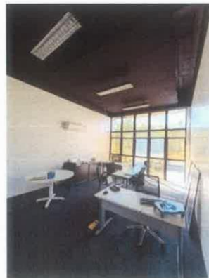
Figura 62 – Divergência teto ambiente PRESIDÊNCIA.
