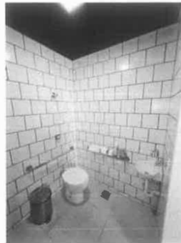
Figura 68 – Divergência teto ambiente SANIT. PNE.
