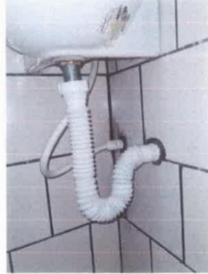
Figura 31 – Inconformidade do tipo de sifão e ausência de acabamento tipo canopia.
