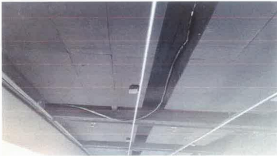
Figura 26 - Tubulação de gas instalada sem uso de ferramenta apropriada. resultado: sem alinhamento.
