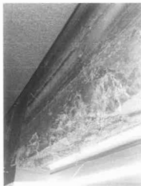
Figura 69 – Ausência de lixamento da superfície de concreto.
