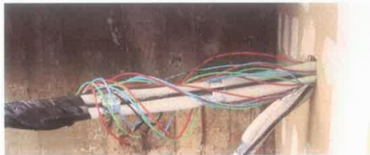
Figura 28 - Fiação sem tubular.
