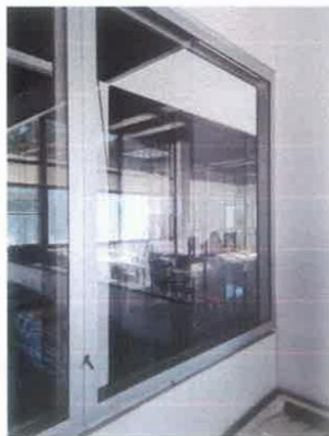
Figura 52 – Ausência de persianas.
