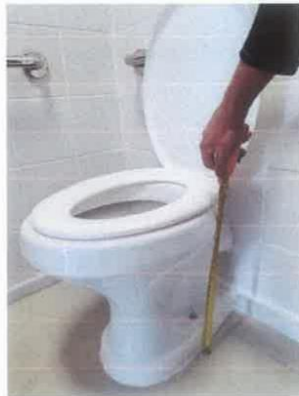
Figura 32 – Inconformidade de dimensão de vaso sanitário.
