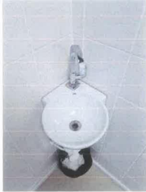
Figura 30 – Inconformidade de dimensão do lavatório.
