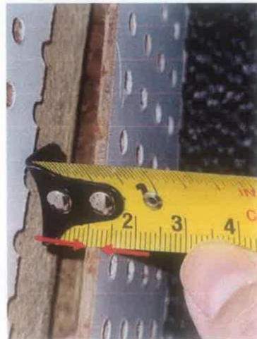
Figura 50 – Inconformidades quanto a espessura da chapa utilizada no painel acústico: instalado peça de 3mm.
