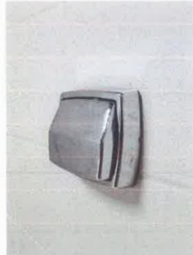
Figura 35 – Inconformidade do tipo de válvula de descarga a ser utilizada.
