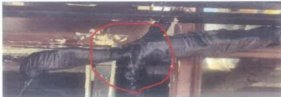
Figura 27 - Tubulação com estrangulamento na passagem de gás.
