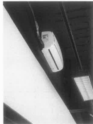
Figura 19 – Ausência do recuo entre parede e teto / Ausência de chapa perfurada.
