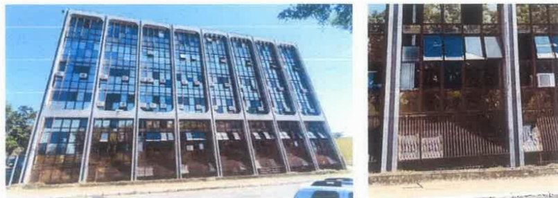
Figura 21 – Ausência da instalação dos suportes metálicos das condensadoras na fachada externa posterior da edificação.
