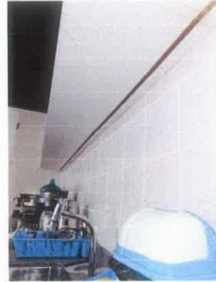
Figura 44 – Ausência de perfil led embutido no armário.
