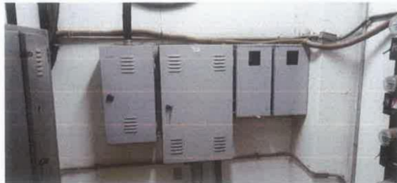
Figura 3 - Conjunto TR de Medição de Energia do CAU-DF
