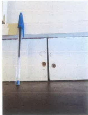
Figura 43 – Falta de acabamento e danos nas peças do rodapé.
